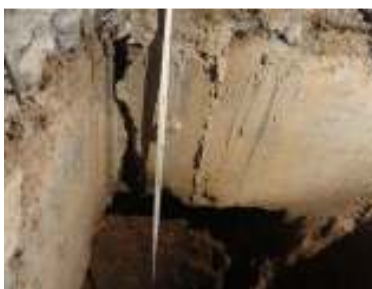
Figura 23 : Encontro fraturado da viga da figura 7 (outra face)
