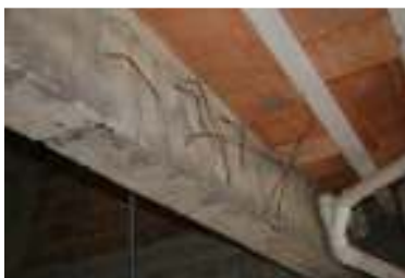
Figura 5 : Viga com estribos cortados e dobrados e falta de espaçadores para armaduras
