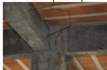
Figura 9 : Junta de concretagem com saco de cimento e ferragens de viga e pilar dobradas
