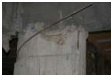
Figura 4 : Armaduras de pilar soltas e junta de concretagem com papel - saco de cimento
