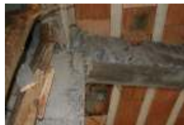
Figura 6 : Brocas, bicheiras e falhas de concretagem e armadura exposta do pilar
