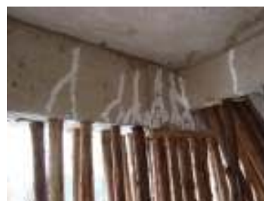
Figura 12 : Viga da fachada com trincas colmatadas
