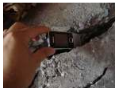
Figura 27 : Abertura da viga das fotos ao lado
