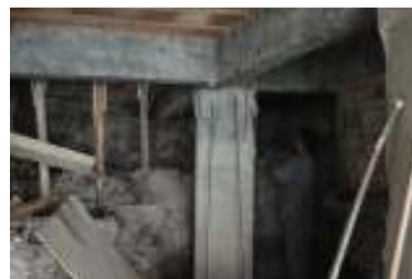
Figura 30 : Pilar P15 após remoção dos entulhos
