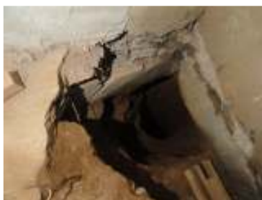
Figura 22 : Pilar apoiado sobre viga – sem fundações
