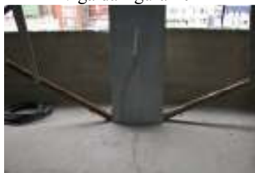
Figura 17 : Pilar com fissura vertical
