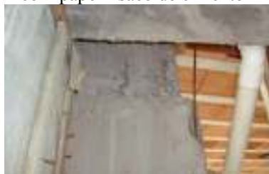
Figura 7 : Pilar com trechos com seção descontínua
