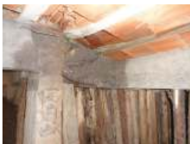
Figura 25 : Tubulão deslocado em relação ao pilar
