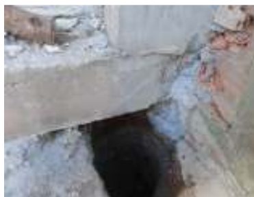
Figura 20 : Tubulão deslocado em relação ao pilar
