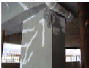
Figura 14 : Pilar de apoio da viga da figura 10
